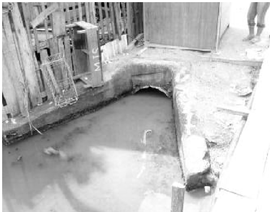
Figura 21. Lançamento de esgotos no Igarapé do Quarenta por meio da rede pluvial.
