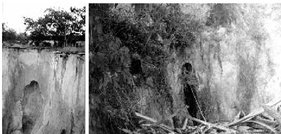
Figura 6. Processos erosivos induzidos por sistemas de drenagem (Distrito Industrial)
