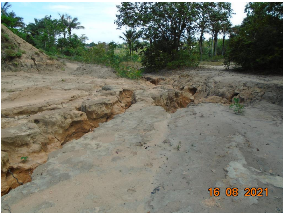
Foto 22. Aspecto do Processo Erosivo (ravinas de erosão) como consequência da concentração de fluxo d'água na área 2 (PT – A2 – F3).
