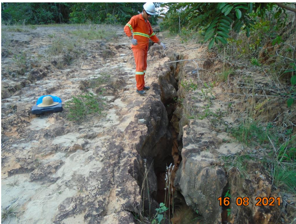
Foto 25. Aspecto do Processo Erosivo (sulcos e ravinas de erosão) como consequência da concentração de fluxo d'água na área 4 (PT – A4 – F5).
