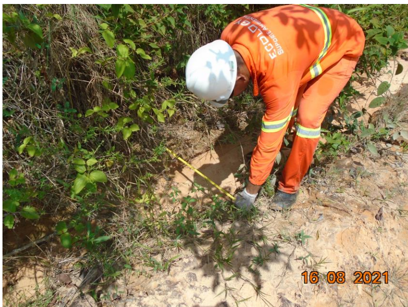
Foto 26. Aspecto do Processo Erosivo (sulcos e ravinas de erosão) como consequência da concentração de fluxo d'água na área 4 (PT – A4 – F5).
