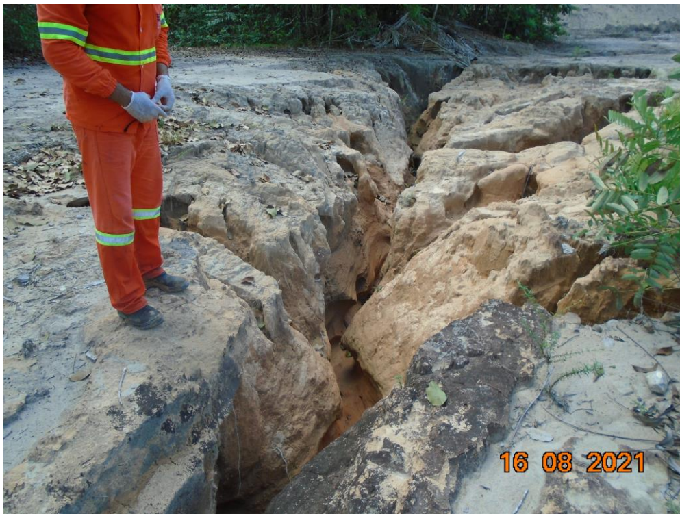
Foto 24. Aspecto do Processo Erosivo (sulcos e ravinas de erosão) como consequência da concentração de fluxo d'água na área 3 (PT – A3 – F4).
