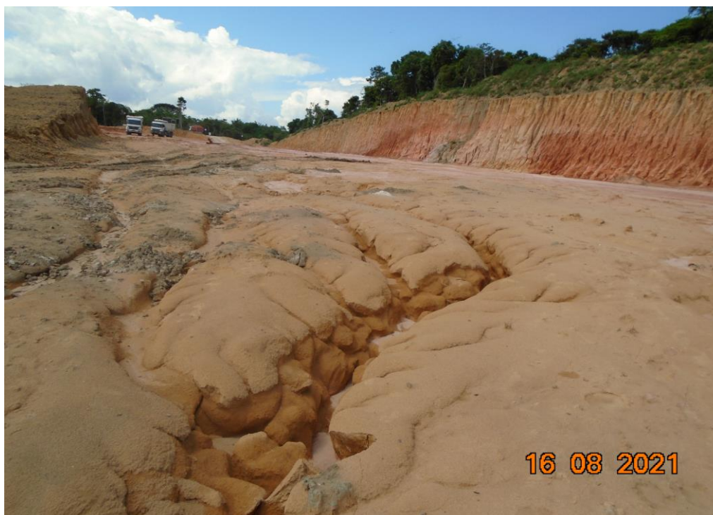
Foto 21. Aspecto do Processo Erosivo (sulcos e ravinas de erosão) como consequência da concentração de fluxo d'água na área 2 (PT – A2 – F3).
