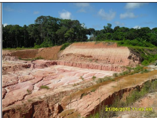
Foto III.1.4.2-2 – Argissolo Vermelho-amarelo com erosão laminar, sulcos e ravina em franco processo de desenvolvimento em obra abandonada externamente a AII.
