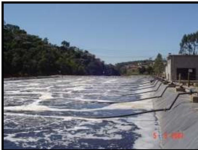
Figura 24 - Tanque de Aeração
