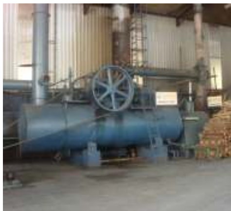
Figura 15- TECNOLOGIAS: Incinerador com Lavador de gases Estação de Industriais
