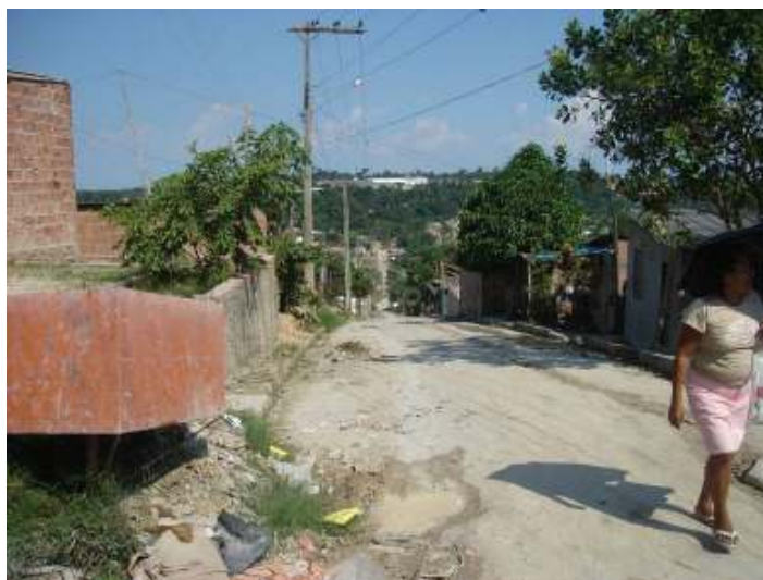
Figura 77. Ruas em péssimo estado de conservação.
