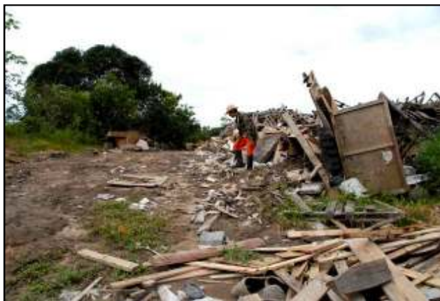
Figura 57. Detritos espalhados pelo chão, os quais foram basculhados afim de haver triagem das madeiras a serem reutilizadas, setor 2, dificultando inspeção.
