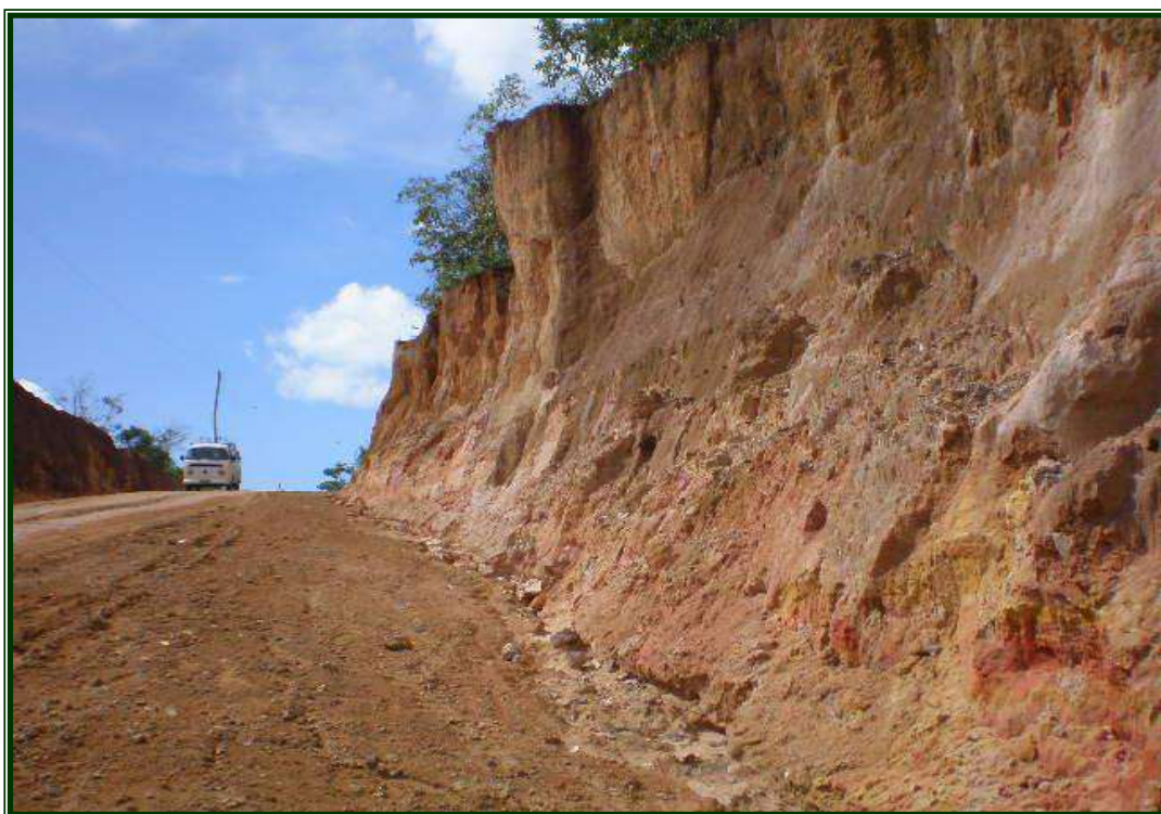
Figura 18 - O material de origem que compõe a base do perfil destas vertentes apresenta-se inconsolidado, favorecendo a instalação de formas erosivas.
