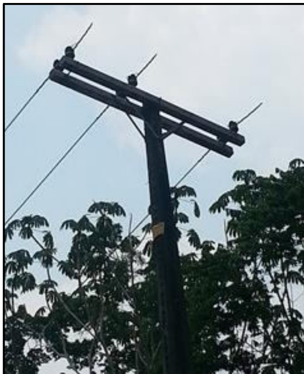
Foto 4.3.3.2.2.4-1 – Poste de Distribuição de Energia.
