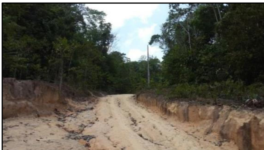
Foto 4.3.6.2.3-7 - Ramal do km 43 – Pista de rolamento com avançado grau de erosão.
