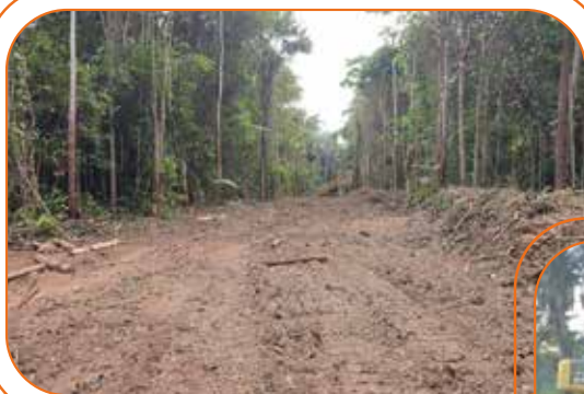
Abertura de acesso a um poço de gás no Amazonas
