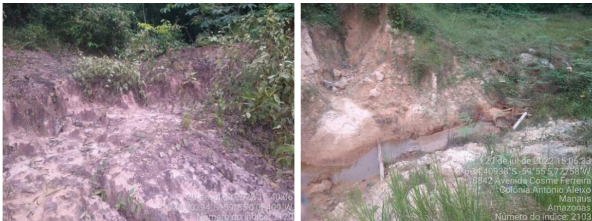
Figura 22 – Aspectos do Latossolo Amarelo e presença de processo erosivo em desenvolvimento
