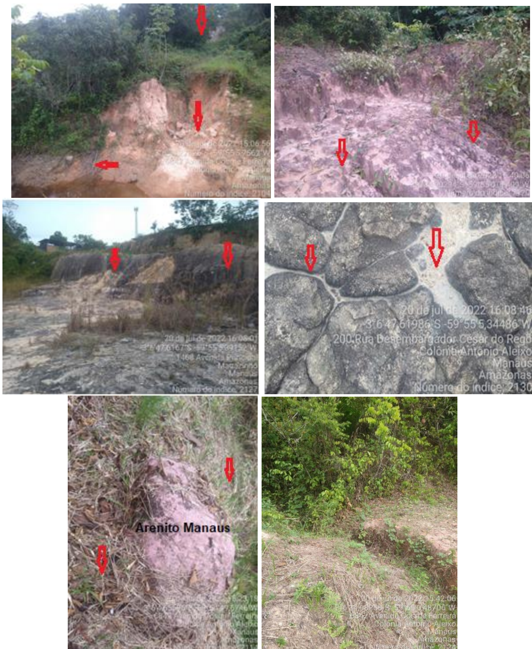
Figura 17– Locais com processos erosivos na AID da UTE Manaus II
