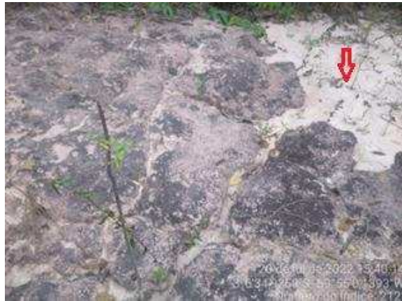
Figura 42 – Identificação dos sedimentos oriundos das erosões.
